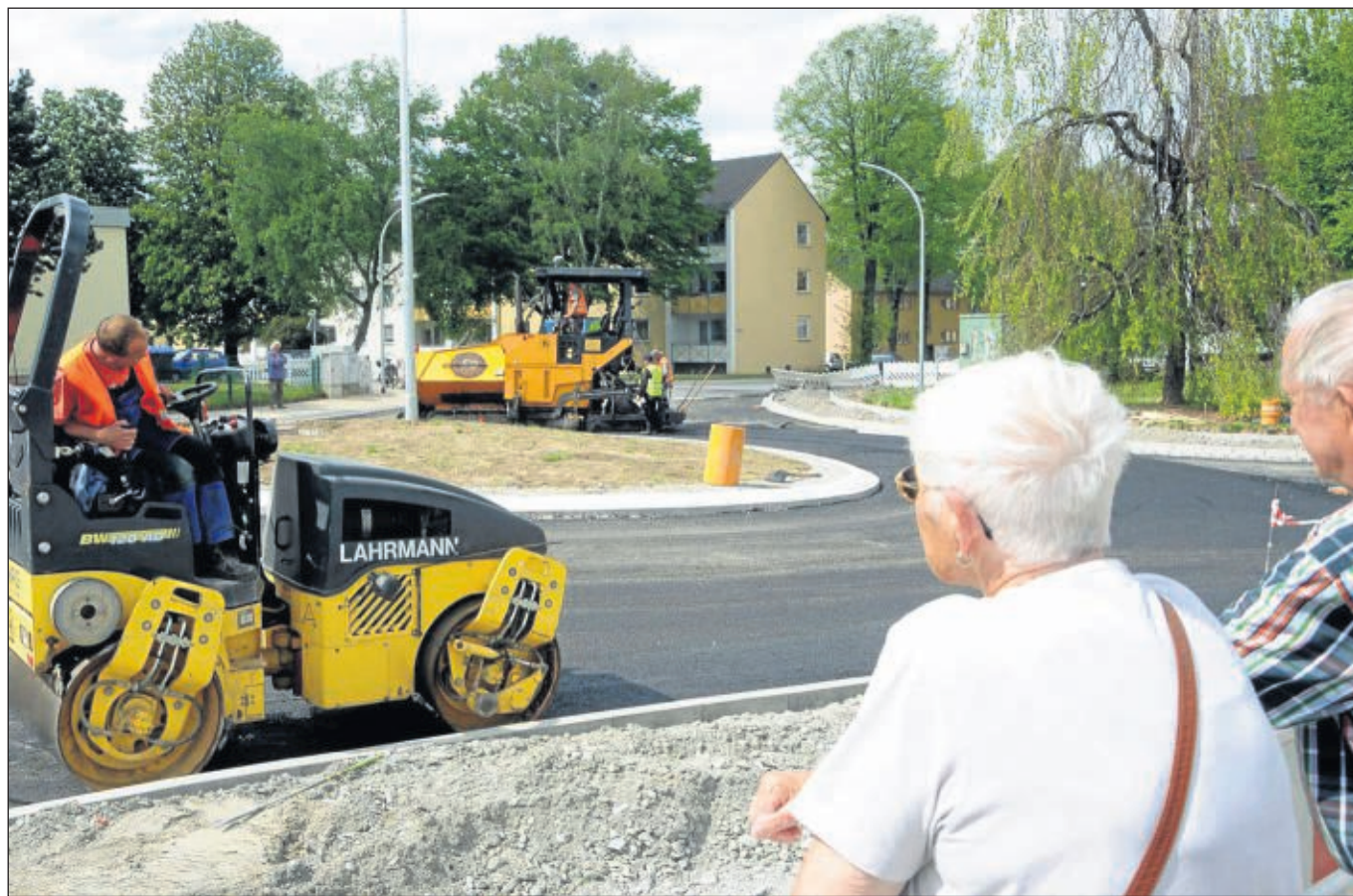
Fast fertig: Eine Dampfwalze streicht den Asphalt auf dem frisch ausgebauten Herzog-Adolf-Weg glatt. Nächste Woche kommt die letzte Decke auf die Fahrbahn; am Montag übernächster Woche können die Autos durch den neuen Kreisell rollen. ■ Foto: Dahm
