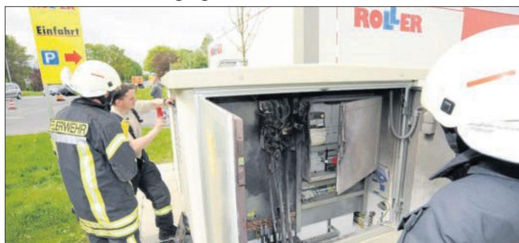
Ein Brand in dieser Trafostation ließ gestern im Möbelmarkt Roller die Lichter ausgehen. ■ Foto: Dahm
